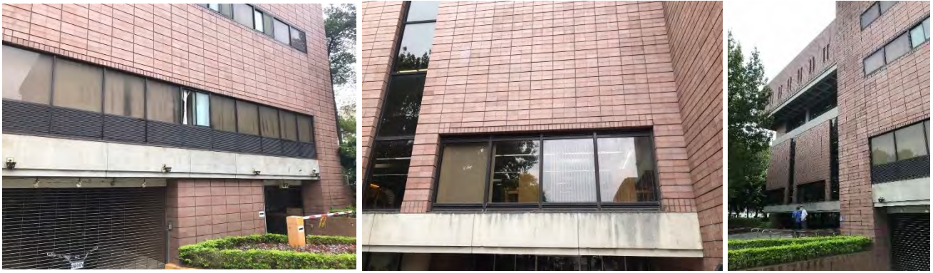
北向立面外牆磁磚現況
