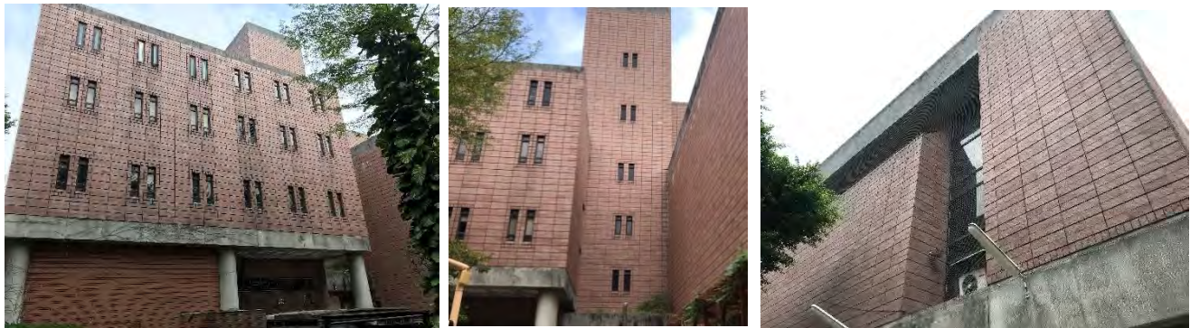
南向立面外牆磁磚現況
