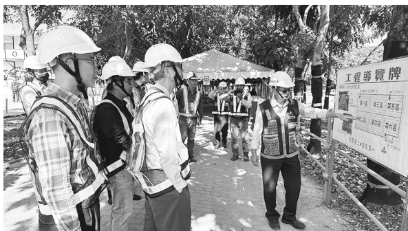
赴南部分館工地召開112年度第4季工程督導會議進行現場施工督導（112年12月18日）
