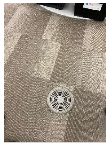
地板上的空調出風口
