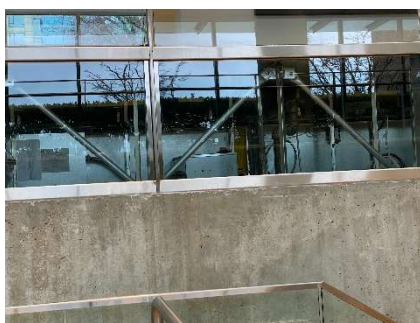
高架地板內之管線
